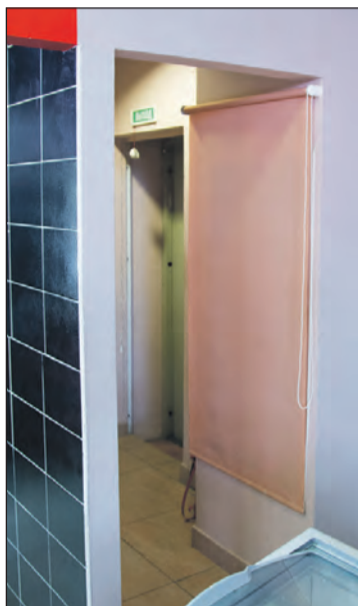
Фуд-корт ТУЦ «Сарафан»: стрелка, указывающую на эвакуационный выход, закрывают жалюзи.
