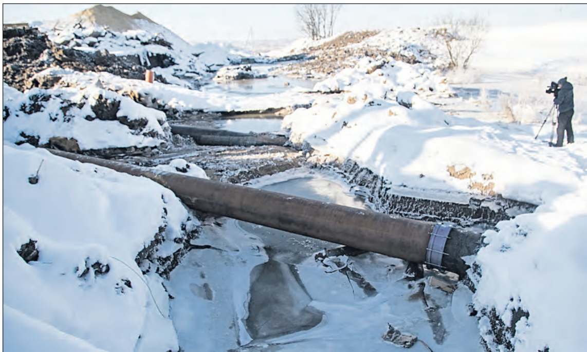
Тула, Пролетарский район. Причина аварии: повреждена водопроводная труба диаметром 900 мм.
