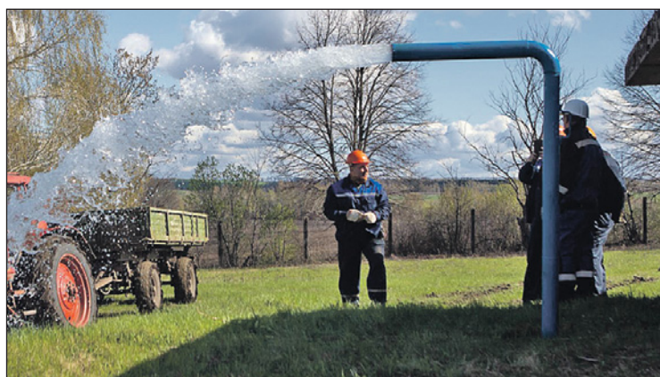
В селе Дубики 27 апреля был заменен насос, после чего пробный пуск воды проверил исправность нового оборудования.
