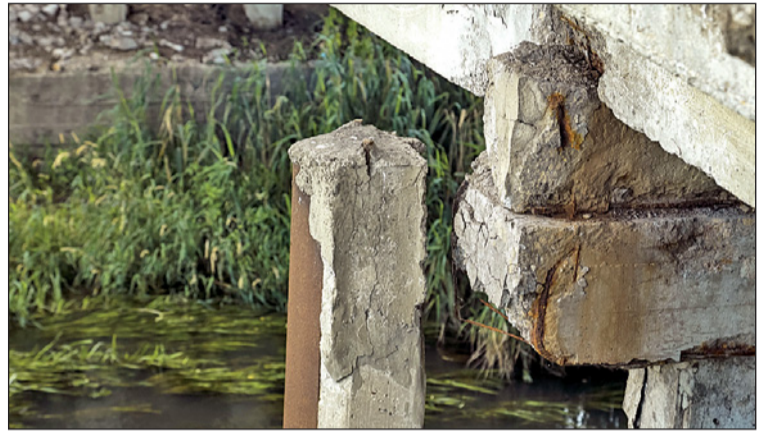
С опор осыпается бетон, из-под него проглядывает изъеденная коррозией арматура. Мосту явно недолго осталось.
