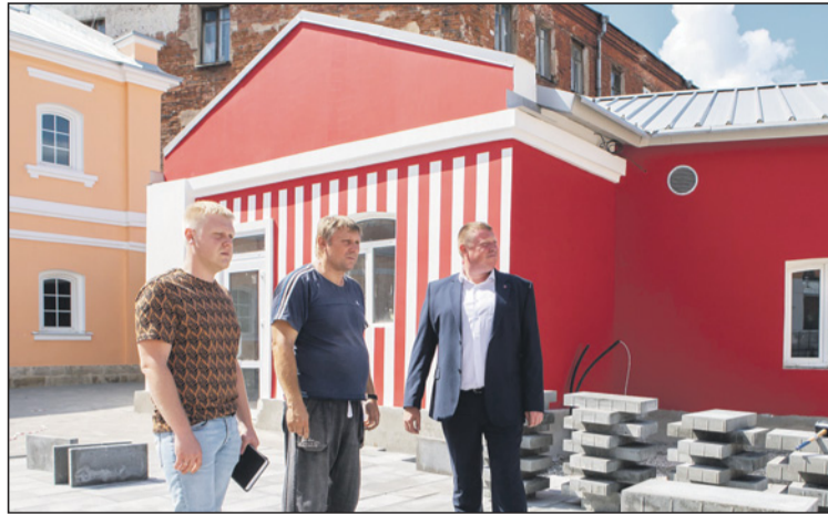
Сергей Ермилов, референт отдела по благоустройству, собственник зданий на ул. Металлистов Александр Пронин и Александр Корнеичев обсуждают ход строительства объектов в Музейном квартале.
