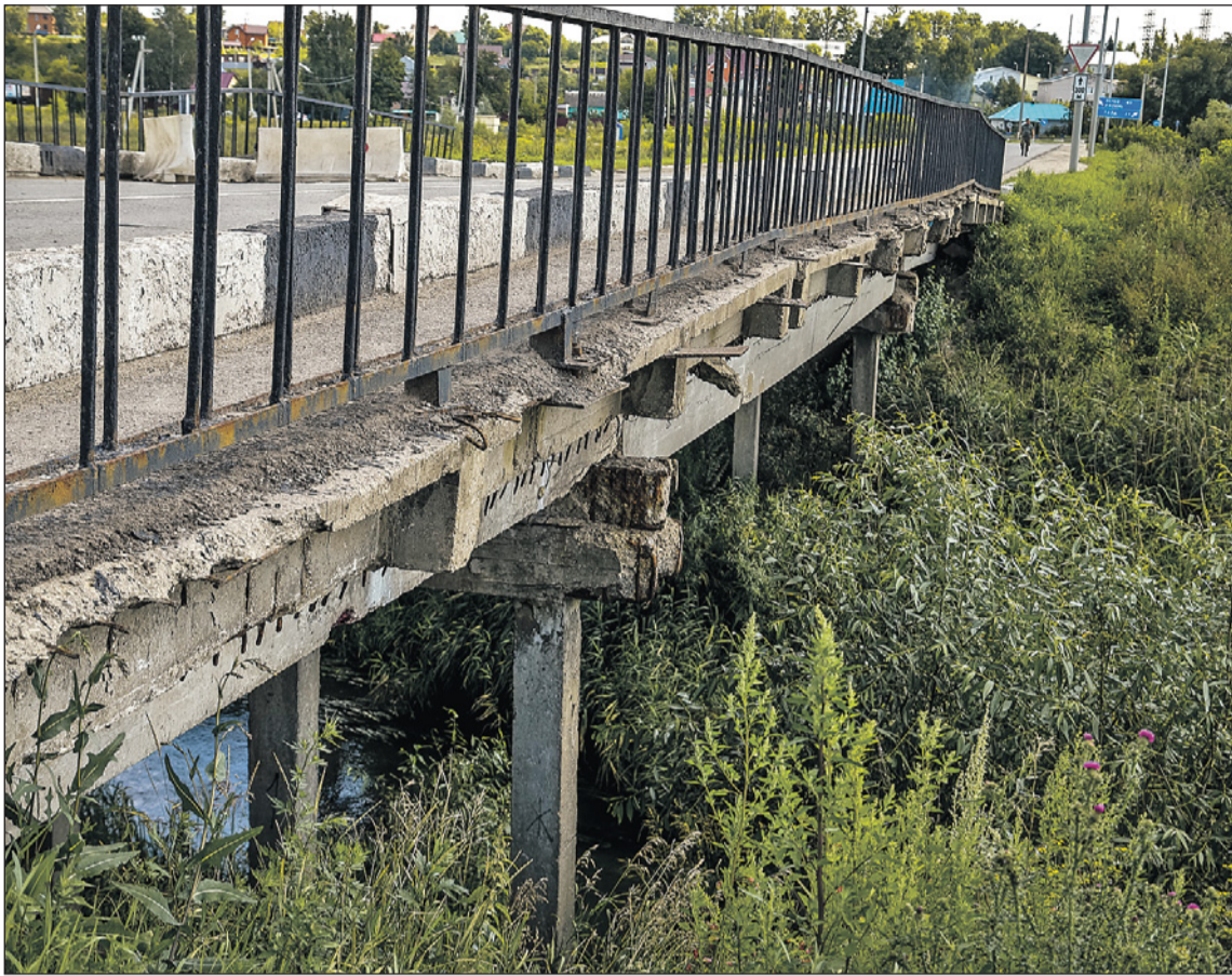
Баташевский мост, который был построен в 1967 году, пришел в ужасное состояние. По нему ездили маршрутки и большегрузы, поэтому движение транспорта закрыли, чтобы не произошло трагедии.
