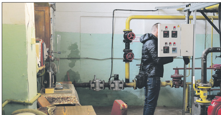
Тула, пр. Ленина, 91. Автоматизация котельных – прежде всего залог безопасности жителей.
