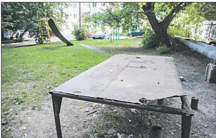
Ржавый стол на детской площадке с кучей мусора под ним явно не укладывается в Правила благоустройства (ул. Дм. Ульянова, 13).
