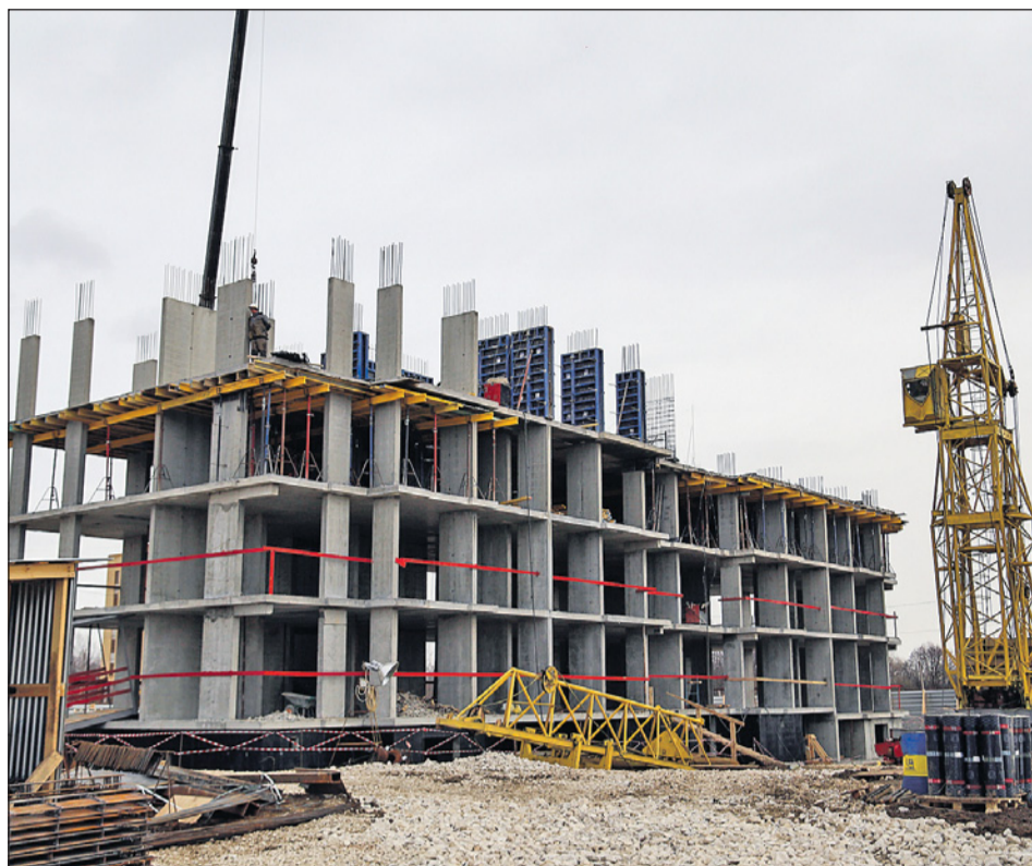
Сейчас на стройплощадке возводятся три дома, которые будут сданы уже в следующем году. Темпы строительства высокие: этаж в неделю.
