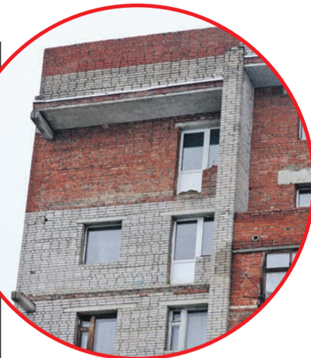
Теперь у жителей этой квартиры за балконной дверью зияет пустота.
