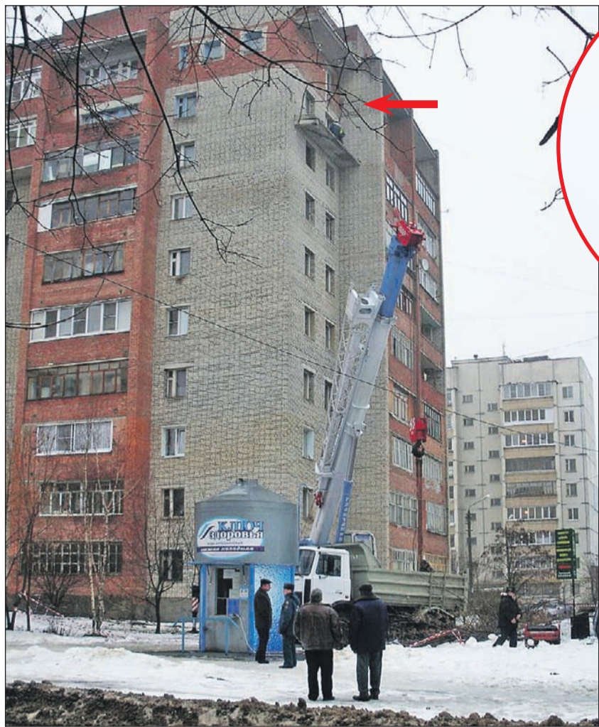
Тула, ул. Перекопская, 7. Бетонная плита упала на пешеходную дорожку. К счастью, на ней никого не было...
