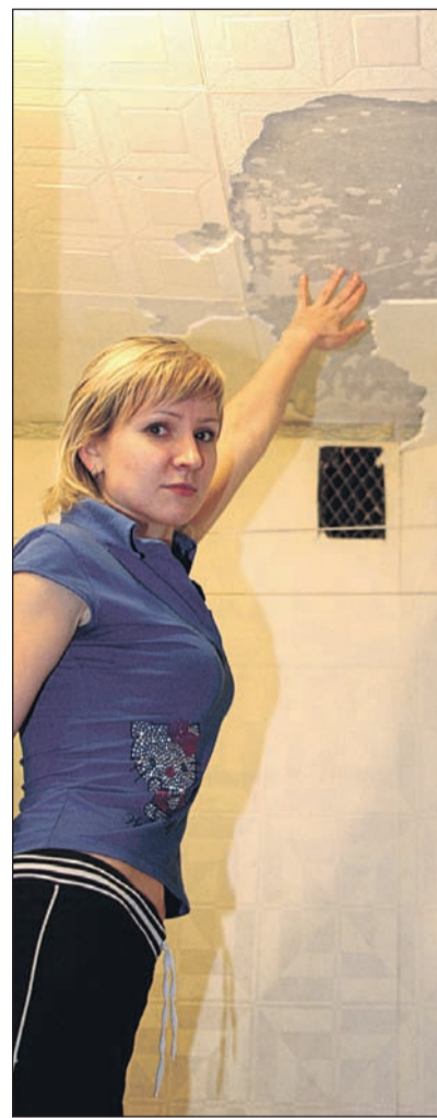
В квартире Надежды Чистяковой провис потолок.
