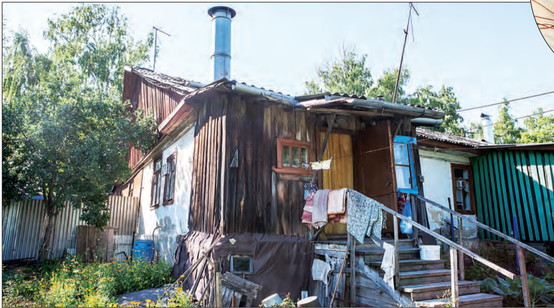
Ул. Клубная, 26. Обшитый клеенкой цоколь дома, почерневшие от времени доски и облупившаяся побелка на фасаде: к чему из этого прикоснулась заботливая рука жилищников – загадка.
