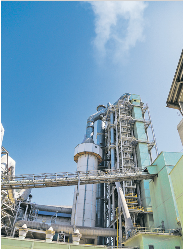
Вид на циклонный теплообменник с трубой для отходящих газов печи. Дыма нет, только пар.
