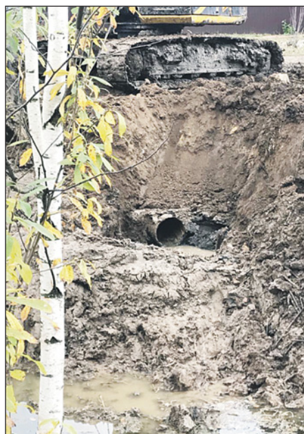
Косая Гора. Активисты поселка вместе с администрацией выявили и ликвидировали незаконные врезки в канализацию с выходом в Воронку: более 10 труб диаметром от 150 до 500 мм!
