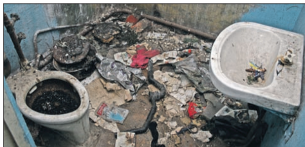
Чтобы отремонтировать этот туалет, потребуются десятки тысяч рублей.
