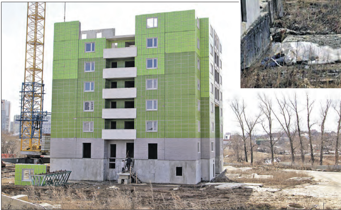
Место происшествия: Тула, ул. Хворостухина, 11. Дом-недострой печально известной компании СУ-155. Стройка заброшена, на территорию может попасть любой – ничего не охраняется.
