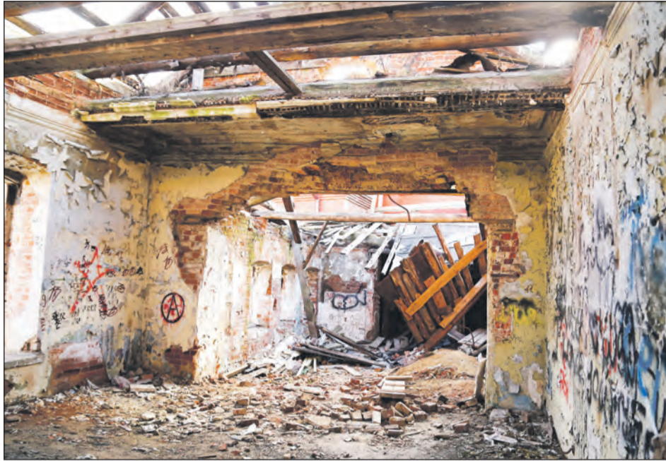
Ул. Metallistov, 8. Эти развалины находятся во дворе отремонтированного здания, куда хотели поселить «Поленовское подворье».
