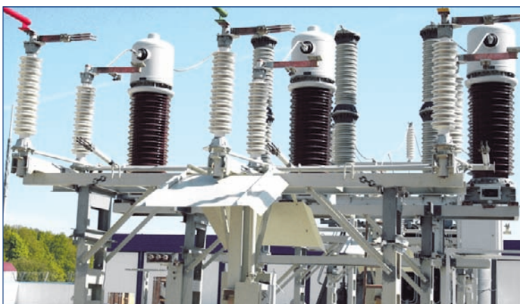
Современное оборудование подстанции гарантирует высокую мощность и бесперебойное энергоснабжение.
