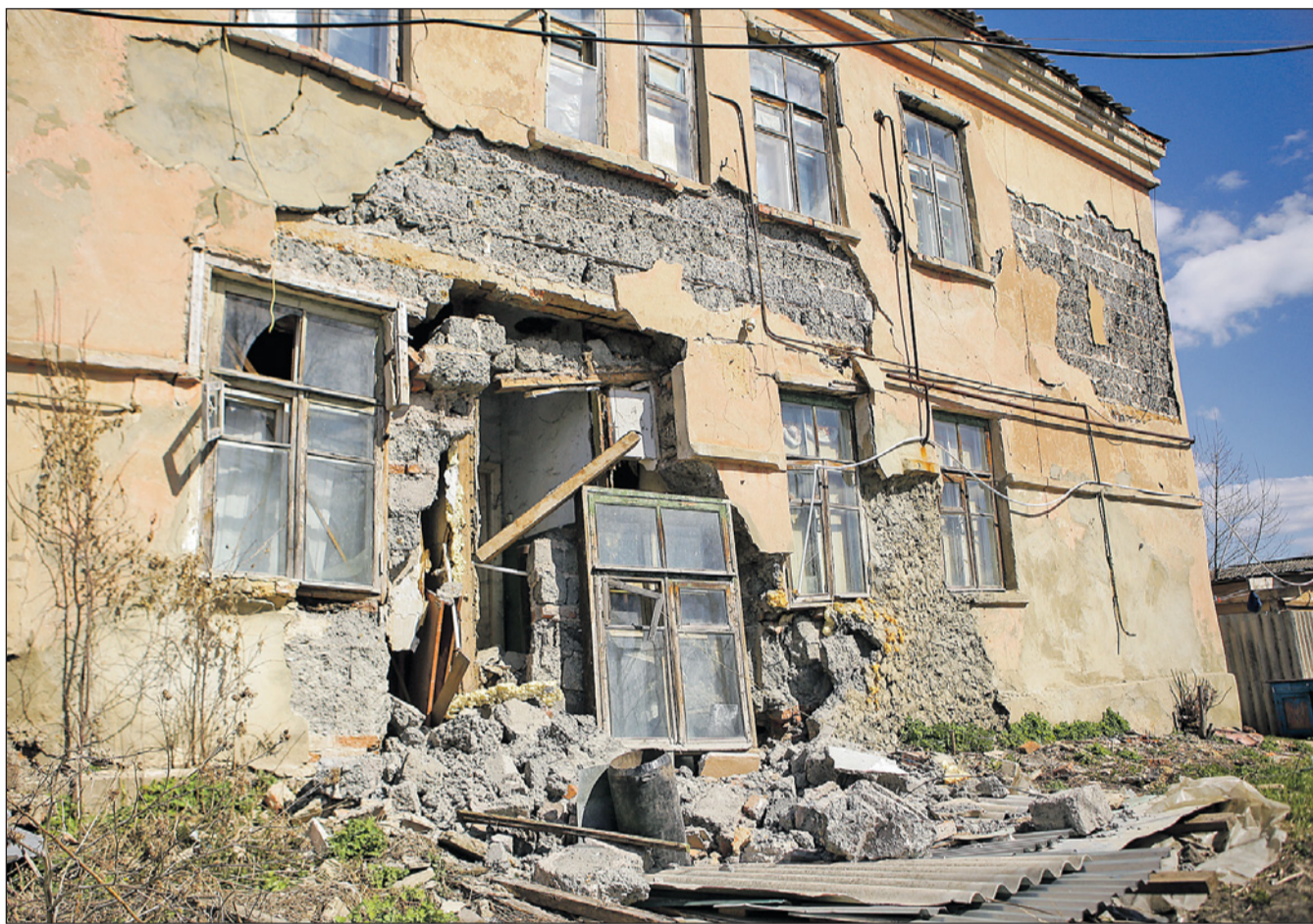
Дом №5 признан аварийным и подлежащим сносу 4 года назад. Он стоял в плане на расселение в 2019-2024 годах.
