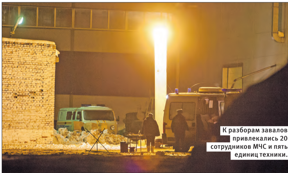
10 февраля, д. Поповка. Крыша цеха по переработке картофеля обрушилась прямо на рабочих.
