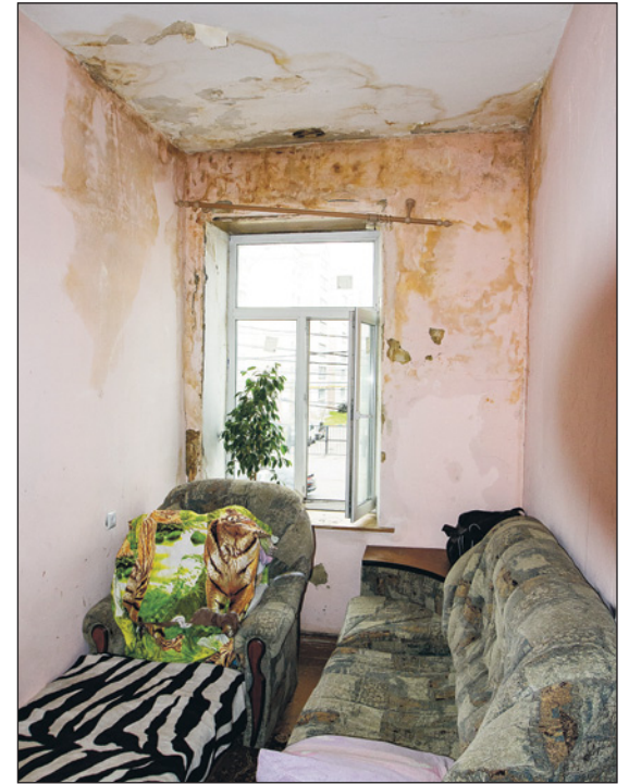
Крыша течет много лет, поэтому стены и потолки во многих квартирах покрыты разводами.
