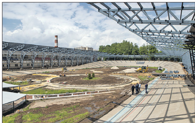
в 2021 году началась реконструкция Тульского велотрека, старейшего в России. Работы закончат в 2022 году.
