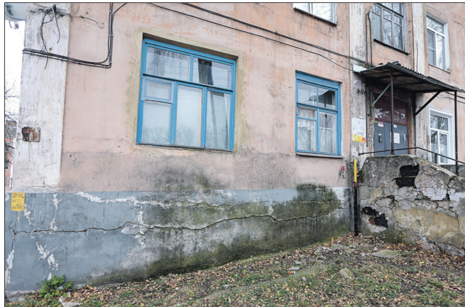
Дом №5 по улице Октябрьской на Косой Горе в Туле признан аварийным. Жить в нем реально опасно.
