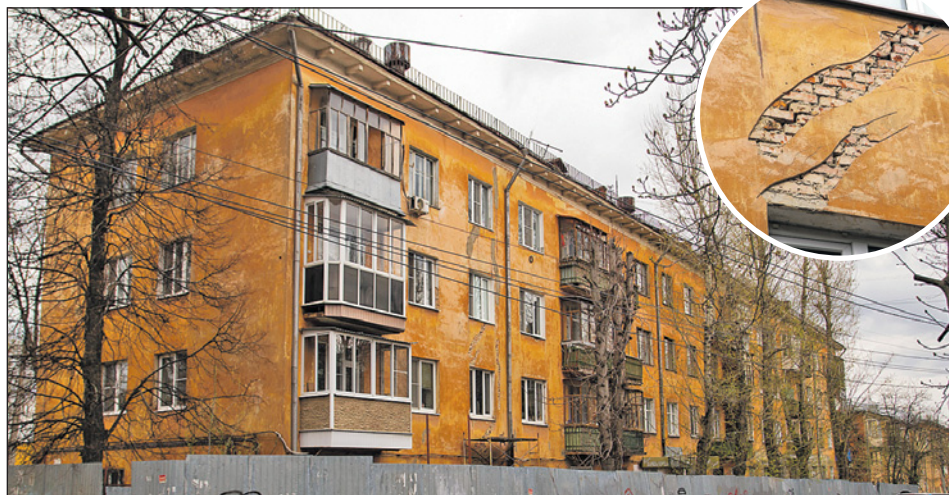
Аварийный дом №6 по ул. Смидович еще обнесен забором, однако работ тут уже никаких не ведется три года. А стены продолжают покрываться сквозными трещинами.
