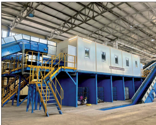
Линия первичной сортировки отходов на новом комплексе в Узловском районе.
