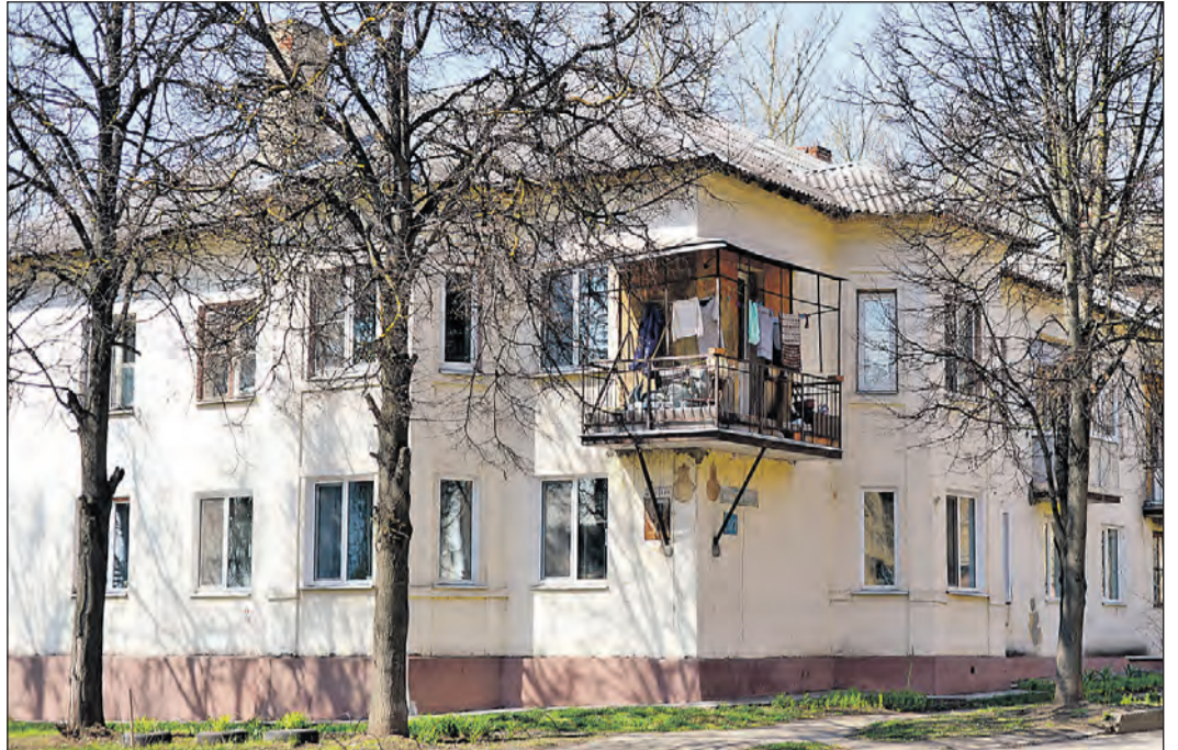
Тула, ул. Макара Мазая, дом 21/7. По программе капремонта, составленной в региональном минстрое, этому дому нужен ремонт крыши и фасада. А жители считают, что отремонтировать надо коммуникации.
