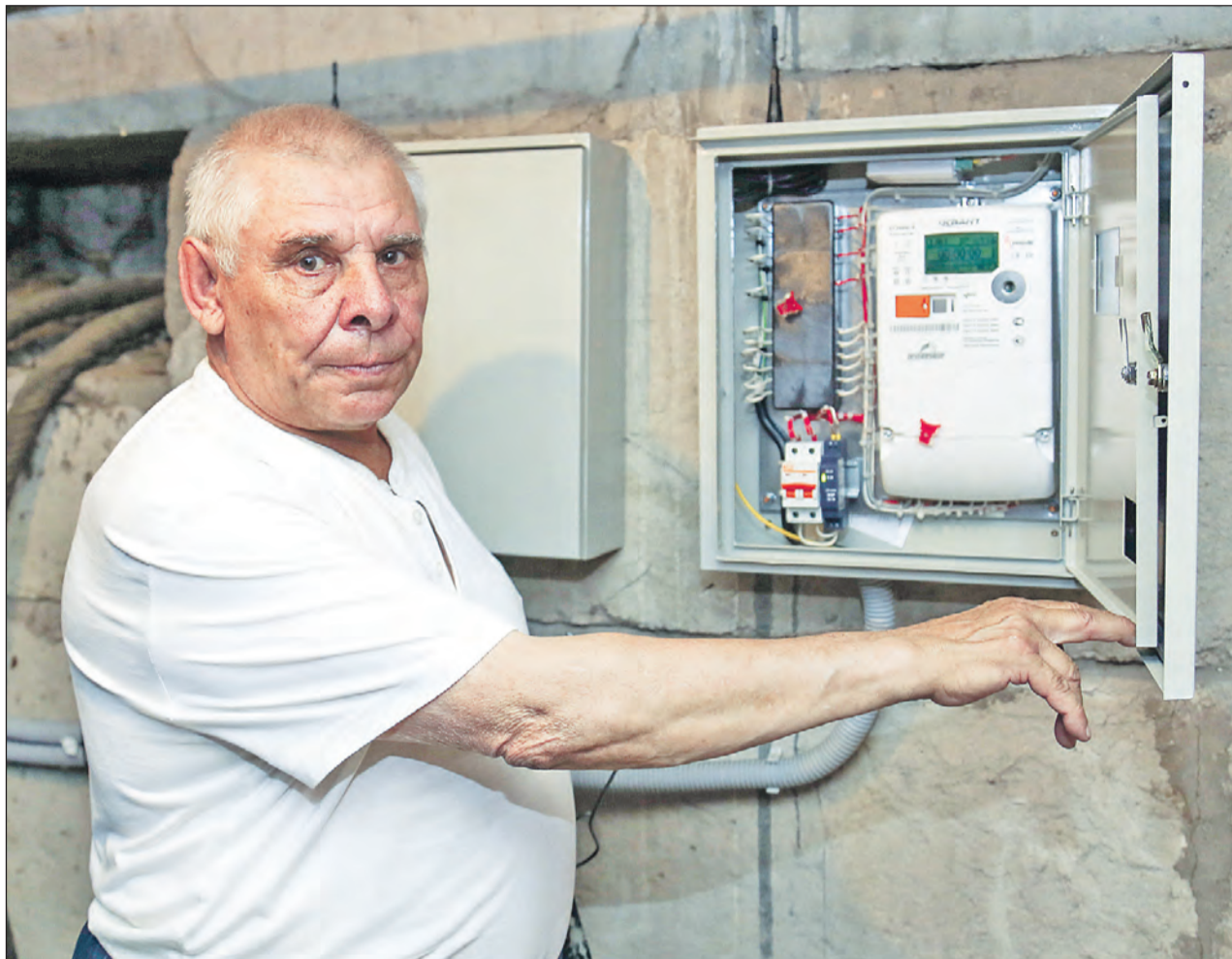
Старший по дому №62 по ул. Металлургов Николай Бондарев ежемесячно лично снимает показания общедомовых счётчиков в каждом подъезде, но в квитанциях почему-то жильцам приходят другие значения электроэнергии.
