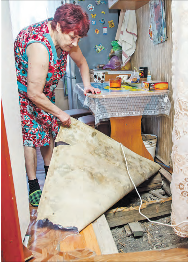
Почти год Антонина Николаевна живёт в квартире с большой зияющей дырой, уходящей в подполье.
