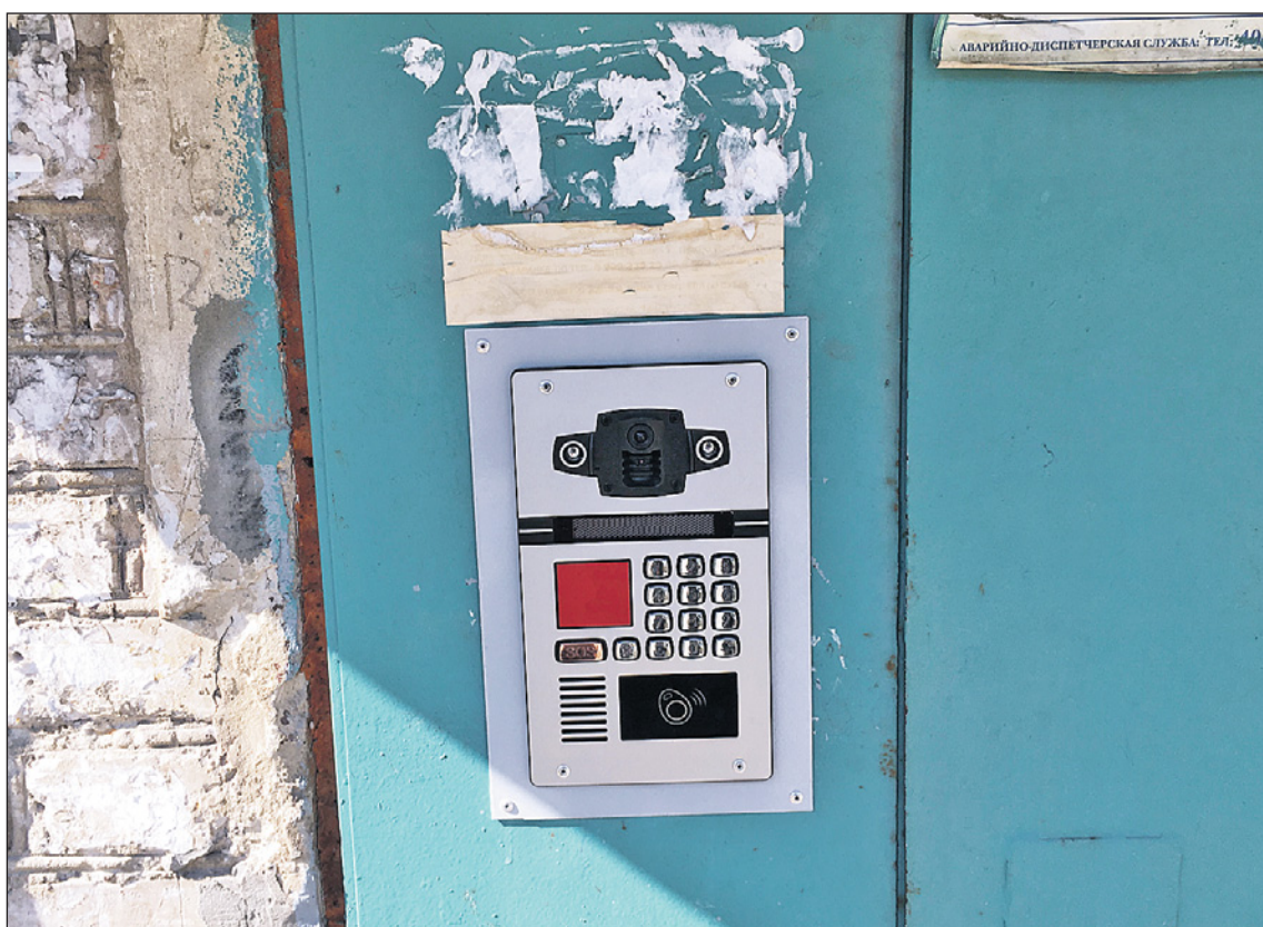
Вот так выглядит умный домофон, который устанавливает одна из тульских интернет-компаний.
