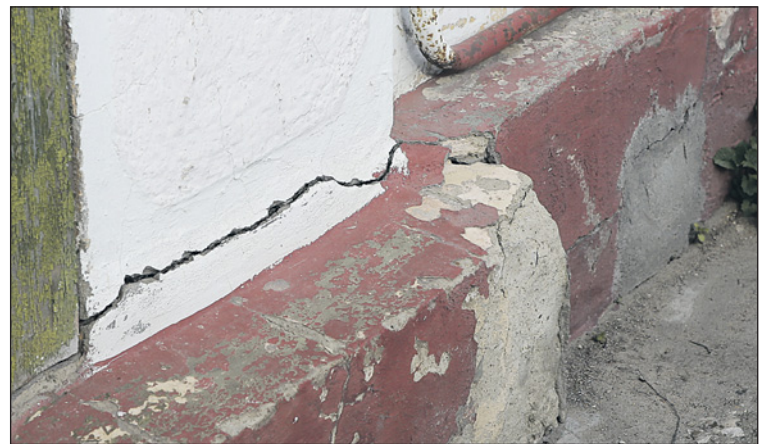
Разваленный фундамент, проваленный пол и отсутствие коммуникаций – не аргумент для социальных служб.
