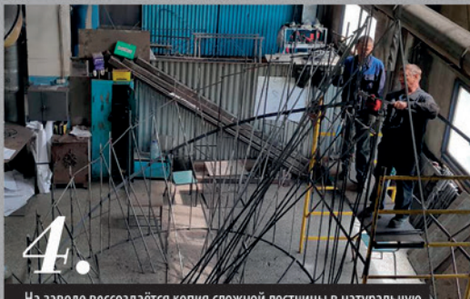
На заводе воссоздаётся копия сложной лестницы в натуральную величину, и на её основе уже «колдуют» опытные кузнецы
