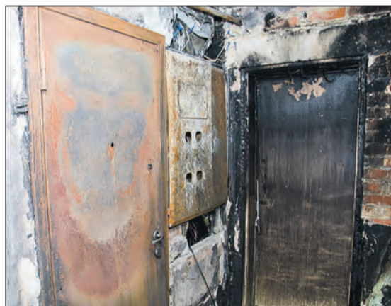
В подъезде выгорели вещи в колясочном помещении, обгорели двери и электрощиток.
