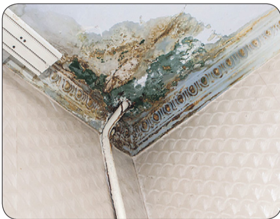
В квартире Владимира Ховрина от постоянных протечек «зацвел» потолок.
