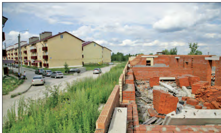
ЖК «Скуратовский» (Варваровка). Застройщик ООО «СтройСервисПроект» в процедуре банкротства. Пять домов в низкой степени завершенности, стройка остановлена. Ситуации с ЖК находится под контролем минстроя Тульской области и инспекции Тульской области по государственному архитектурно-строительному надзору. Обманутых дольщиков 40 чел.
