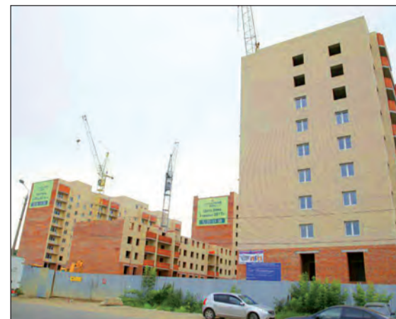
ЖК «Александровский парк» на ул. Октябрьской в Туле. Бывший застройщик ООО «Анкер». Сейчас идет судебное разбирательство о признании его банкротом. С ноября 2016 года достраивает три корпуса ЖК новый застройщик – ЗАО «Инвестиционно-строительная компания».
