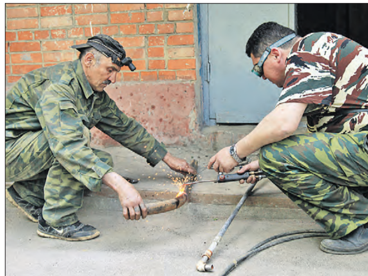
Сотрудники компании Николай Ксенофонтов и Александр Мацуков проводят ремонт трубы в доме на Красноармейском проспекте, 4.
