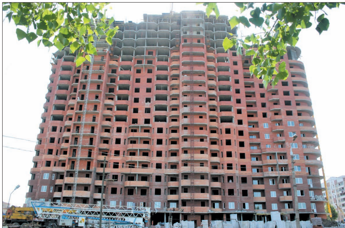
Строительство первого дома жилого комплекса «Платоновский лес» подходит к концу – уже в сентябре этого года дом будет сдан госкомиссии.
