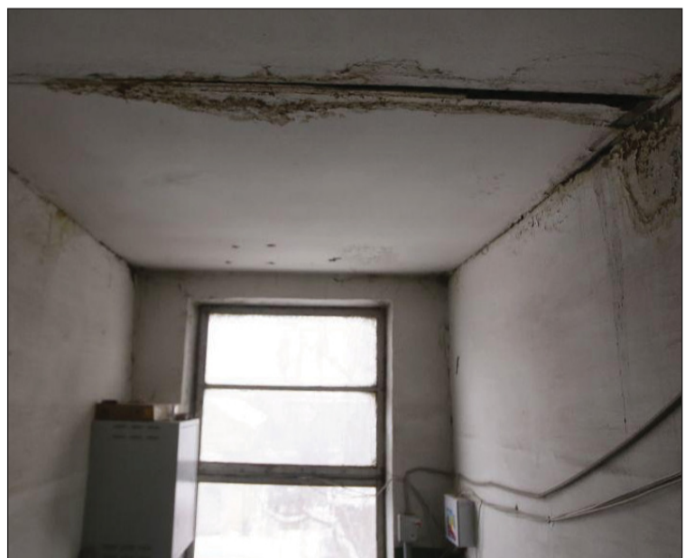
Крыша течет не только над квартирами, но и в подъезде уже не первый год.
