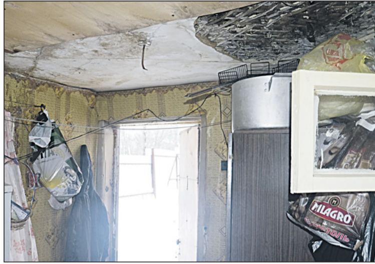
Из-за постоянно протекающей крыши штукатурка с потолка на террасе и в кухне то и дело обваливается. Чудо, что не на детей.
