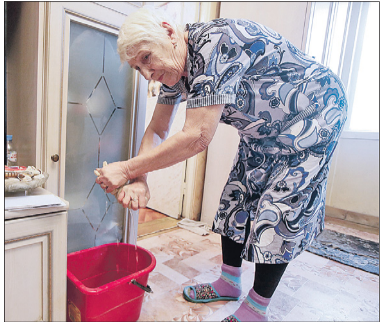
Из-за поврежденной крыши Нине Горицкой практически целый день приходится с тряпкой в руках собирать воду с пола.
