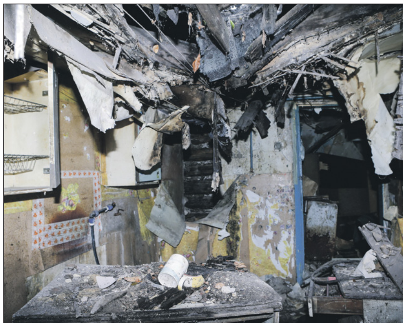
Во время обрушения потолка сломалась гнилая газовая труба.
