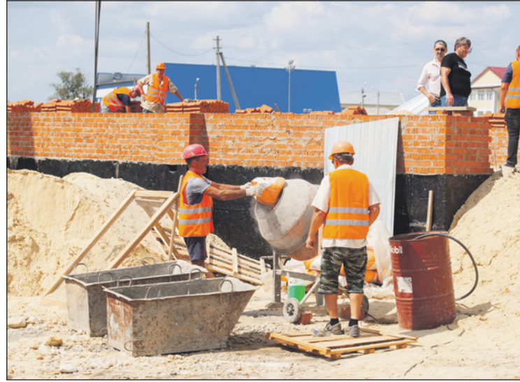
На 1 августа фундамент здания выполнен на 100%, строители приступили к возведению кирпичных стен здания.
