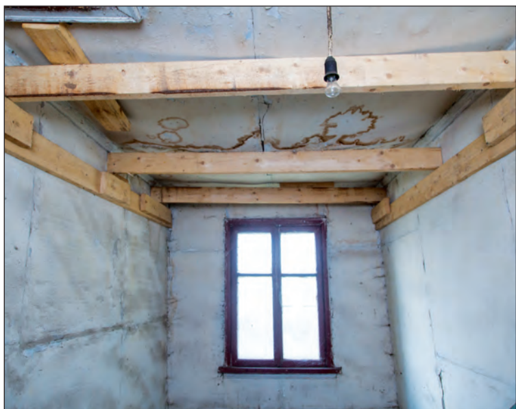
Второй этаж дома №10 держится на честном слове и деревянных распорках.
