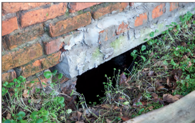
В этих домах нет подвала, и дыра внизу – не вентиляционное окно, а халтурно отремонтированная кладка.
