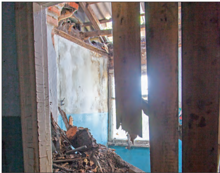
Провалившийся потолок в одной из квартир. А на этаж ниже все еще живут люди.
