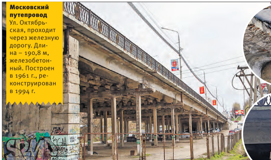
Путепровод в кошмарном состоянии: ржавая арматура, плохие опоры. Даже неспециалисту понятно – этому мосту срочно нужен ремонт.
