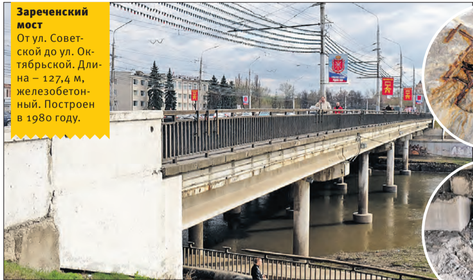
С виду мост крепкий. Но снизу в середине пролётов уже есть крупные ржавые пятна. А береговые опоры – в крупных трещинах: их точит вода.
