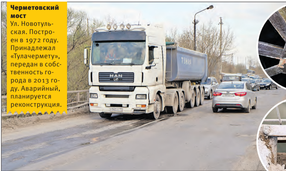
Много лет мост на «Чермет» находится в аварийном состоянии. Он опасен для туляков. Власти обещают его реконструировать. Другого пути нет.
