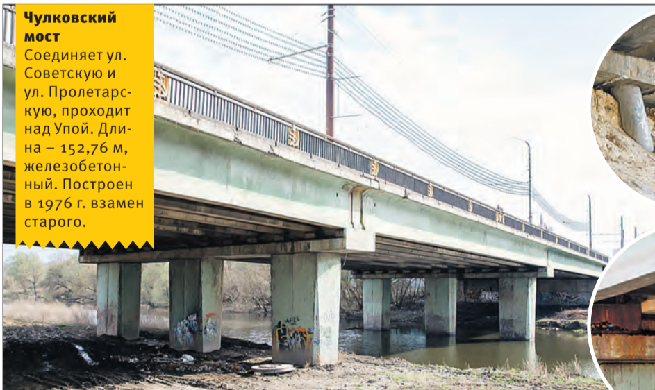
Береговым опорам помогают разрушаться сами горожане: здесь открыли настоящий песчаный карьер! Балки обнажились, подпорки выглядят ненадёжно.
