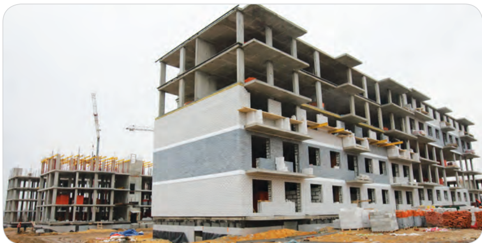
Уже сейчас, за 9 месяцев до сдачи, многие дома практически построены. Возведены каркасы, идёт обкладка кирпичом.
