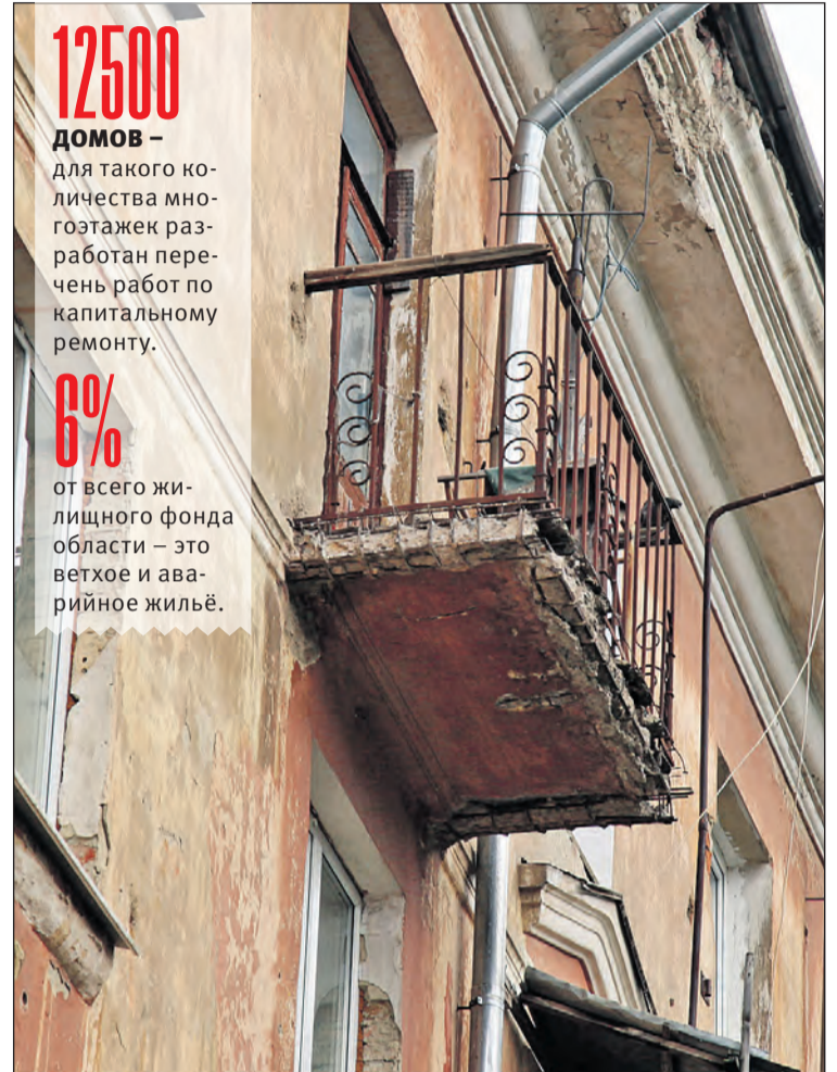
Под таким балконом косогорцы опасаются проходить. А сам фасад дома, по словам жителей, буквально крошится.
