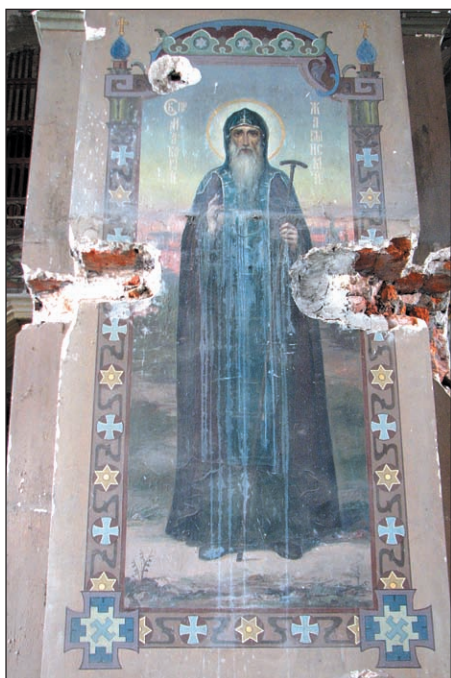
В советское время в храме были устроены перекрытия для хранения архивных материалов, из-за чего опоры здания разрушились.
