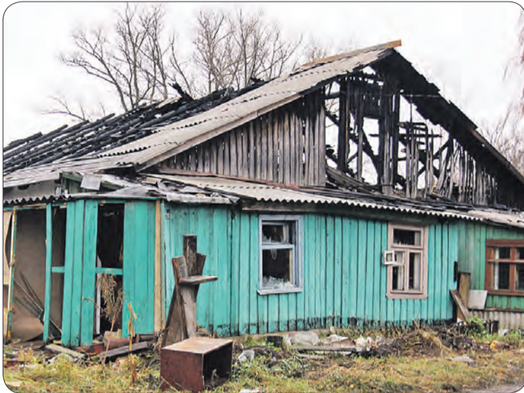
Аварийные бараки в п. Победа не сносят, а почему-то поджигают. Жители соседних домов опасаются, что огонь перекинется на их жильё.
