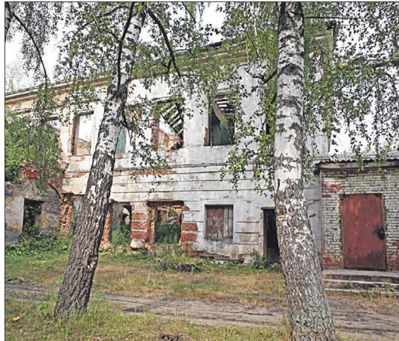
Так усадьба Гартунгов выглядит сейчас. В 1986 году на ремонт крыши этого дома у Департамента культуры не хватило 50 тысяч рублей (ремонт стоил 70 тысяч).
