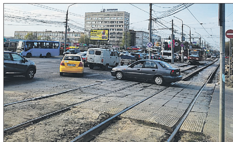
После ремонта трамвайных путей и дорожного покрытия администрация обещала восстановить покрытие тротуарной части.
