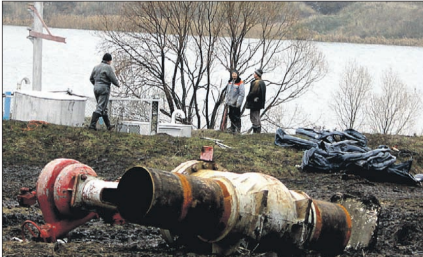
Плановый ремонт привел к тому, что дизтопливо попало в Упу. И немудрено – магистраль расположена не далее нескольких десятков метров от воды.
