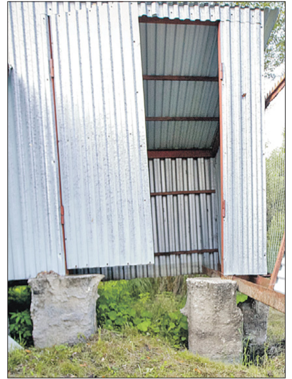
Полутонные бетонные блоки на участке выдавило из земли в конце февраля 2018 года.
