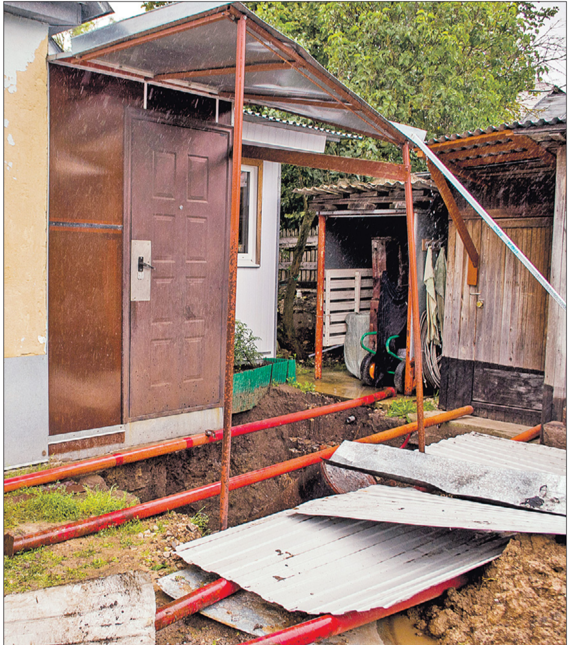
На засыпку многометровой воронки понадобился десяток КамАЗов со строительными материалами. Впереди вторая часть работы — экспертиза для выяснения состояния почвы под самим домом.
