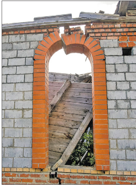
Стены бани не выдержали зимы и треснули. Теперь недострой придется сносить.
