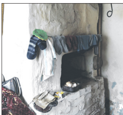
Отопление в доме еще печное! Как при царе Горохе.
