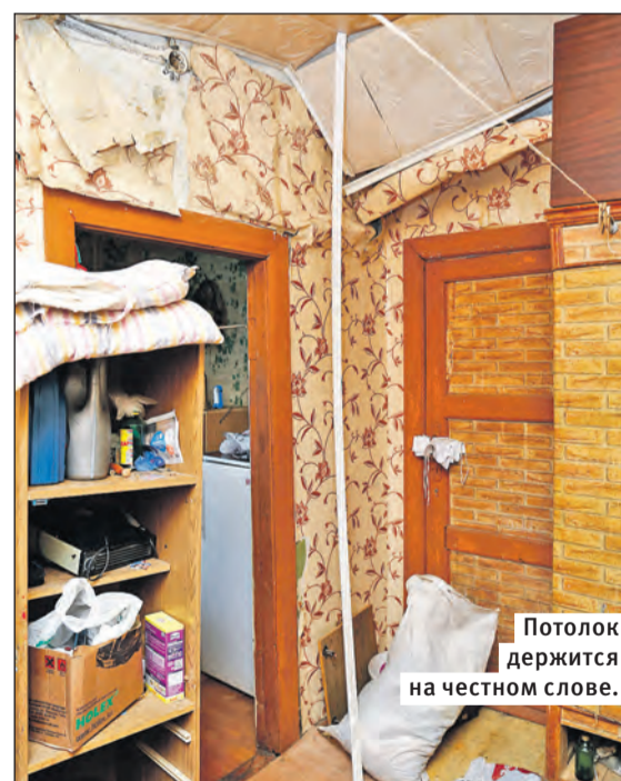
Стены в квартире идут «волнами».
