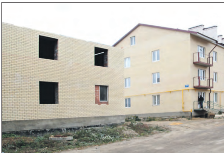
В Варваровке сдали в эксплуатацию дома, непригодные для проживания. Документы были подписаны даже на здания без крыши.
