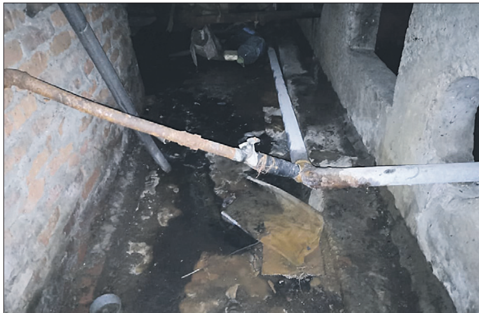
Так подвал выглядит после откачки канализации из него. Очевидно, что за состоянием сетей тут никто не следил
