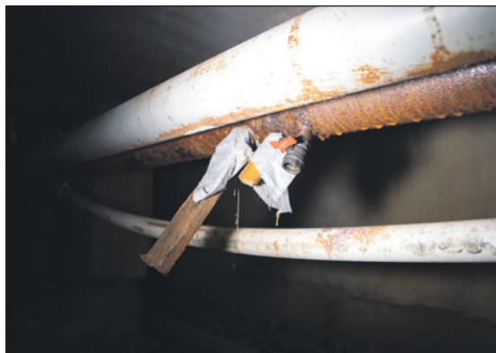
Деревянные чопики с тряпками в качестве «гидроизоляции» – единственные следы ремонта.
