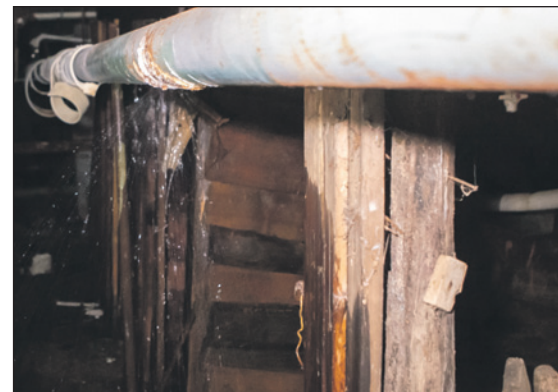
Прорывы в трубах холодного, горячего водоснабжения, канализации продолжаются около 5,5 лет.
