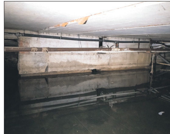
Самая нижняя часть подвала уже превратилась в настоящий бассейн.
