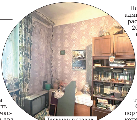
Трещины в стенах от пола до потолка!
