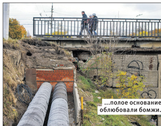
Бетонные плиты рассыпаются...
